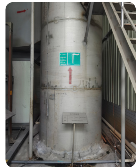
废气处理设施
